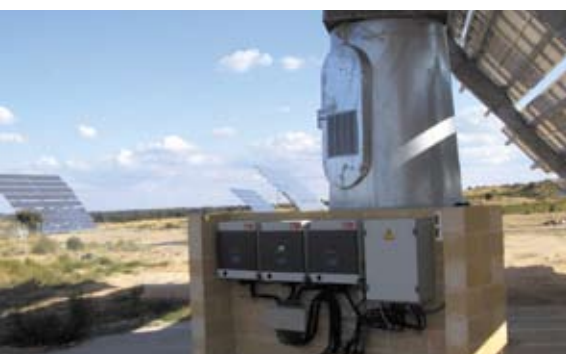
400kW-Anlage, Trackersystem (Spanien) 400kW Installation (Spain)
