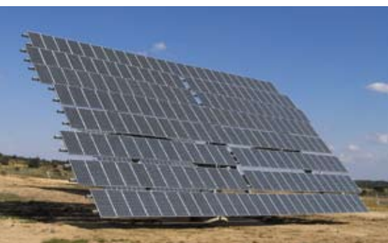
400kW-Anlage, Trackersystem (Spanien) 400kW Installation (Spain)
